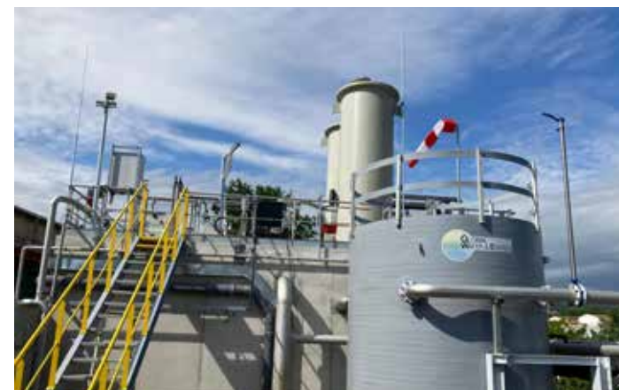
Een installatie van GWE bij Heineken in Marseille.
